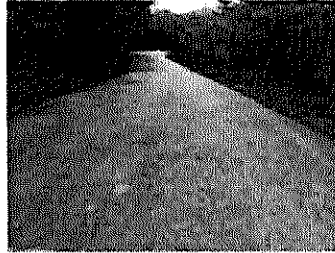
Fotografía No. 1: Vista general, punto donde se presentó el hundimiento alzado
